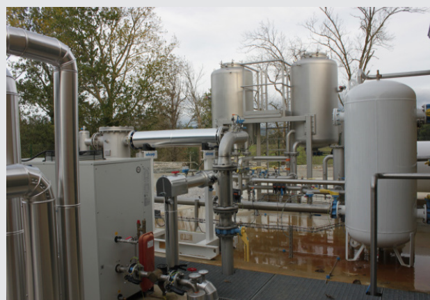
Biométharn (Tarn) : poste de traitement du gaz pour son injection dans le réseau ©photo par Solagro
