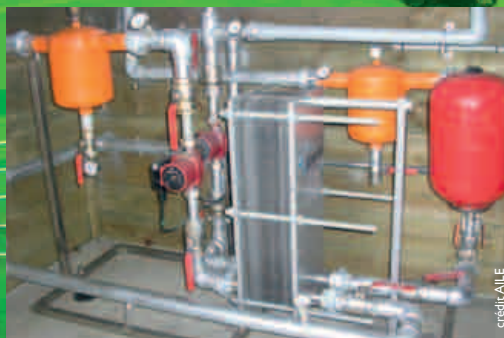
Echangeur thermique dans un atelier de canards à la SCEA du Bois Brillant dans le Maine-et-Loire
