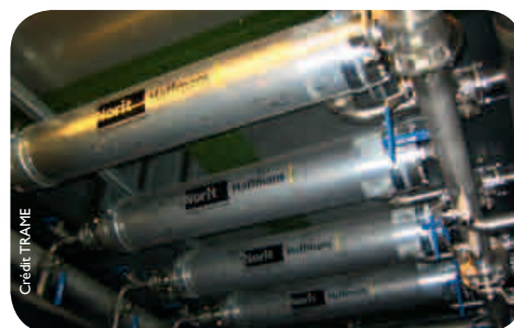
Épurateur membranaire de biogaz
